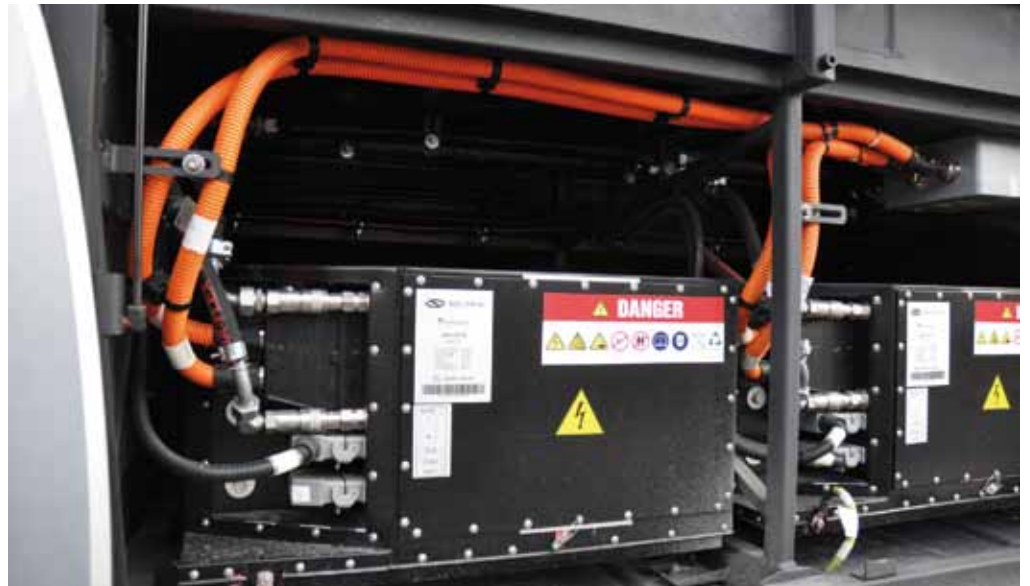
Solariksessa on 7kpl 88kW akkuja = 616kW, joista neljä on alhaalla ja kolme katolla. Korkeajännitejohdot on merkitty oranssilla päällyspotkilla.
